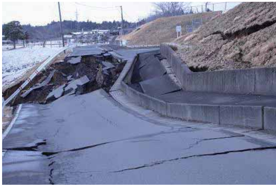
崩壊した道路（東和総合運動公園前）
