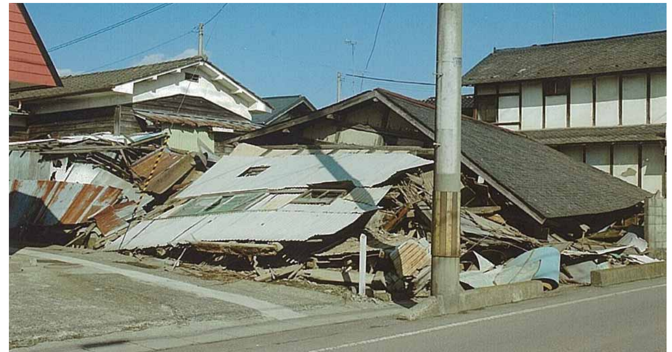
倒壊した中町地区の住家
