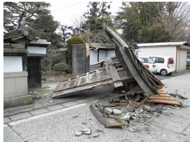
地震で倒壊した武家屋敷の門
