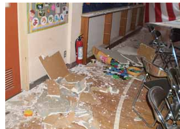
天井や壁の石膏ボードが落下した米山西幼稚園
