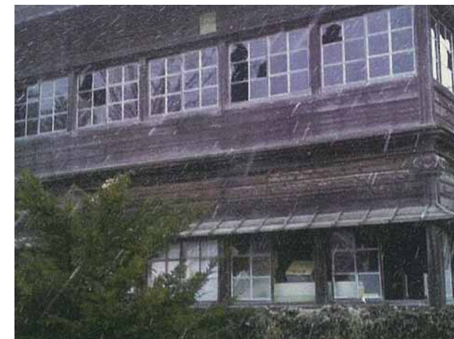
登米教育資料館 地震により窓ガラスが破損・落下
