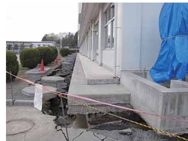
中津山小学校 校舎周囲の陥落
