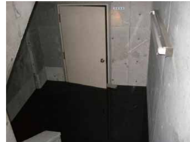
■迫中継ポンプ場 流入ゲートの故障により地下2階の汚水槽を越流し地下1階の配電盤室にまで浸水。写真は地下1階が満水となり地上階の途中まで水が迫っている状況
