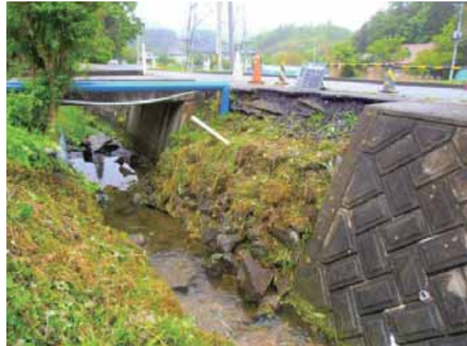
館の下川(東和町米川)被災状況
