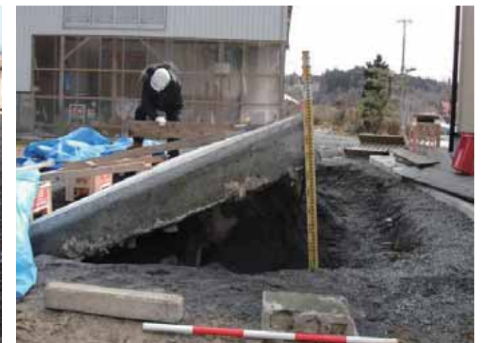
市設置型浄化槽の浮き上り
