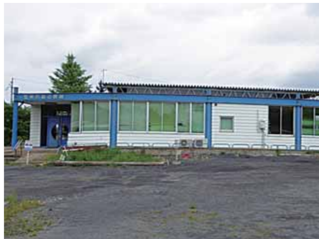
建物全体が歪んでしまった森公民館
