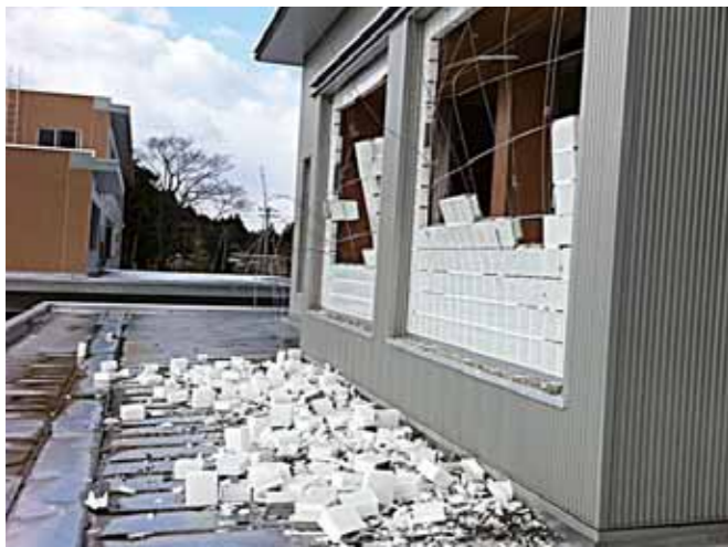
新田小学校 体育館のガラスブロックが落下
