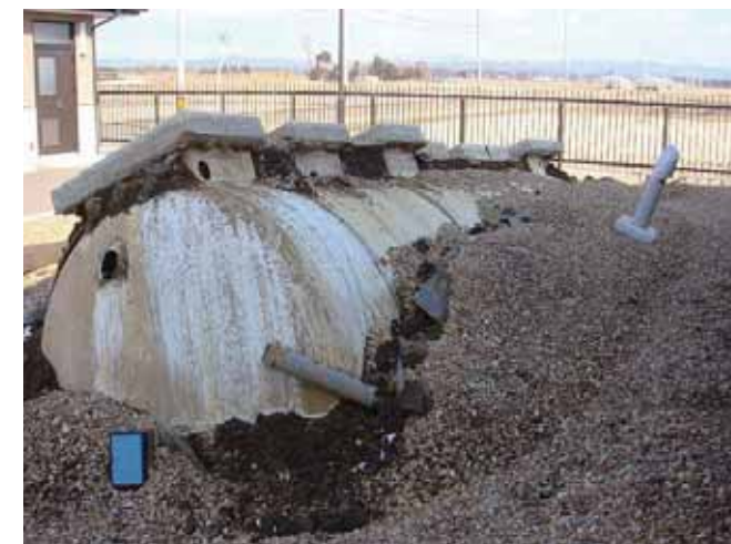
砥落農業集排処理場の浄化槽部分の浮き上り
