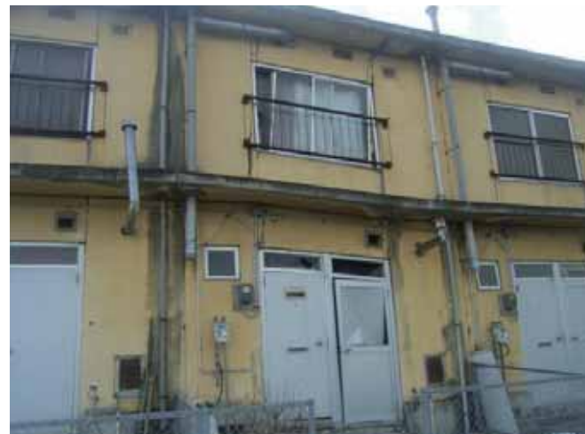
清水第2住宅 損傷状況
