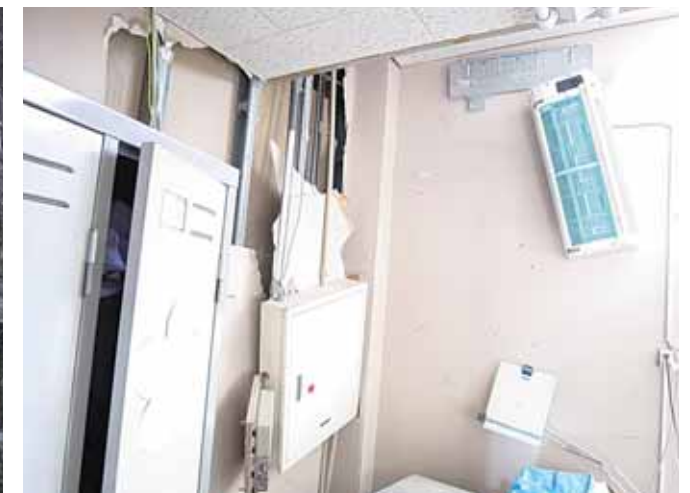
米山学校給食センター 天井と壁が損傷
