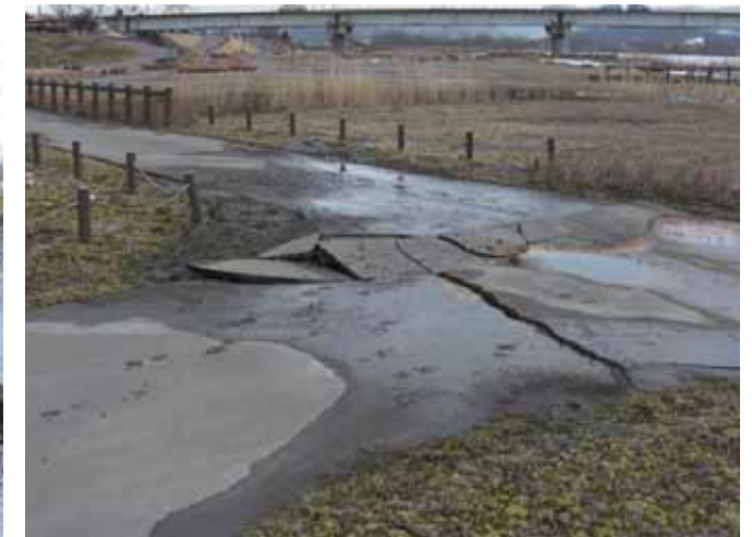
豊里水辺の公園 舗装通路の損傷
