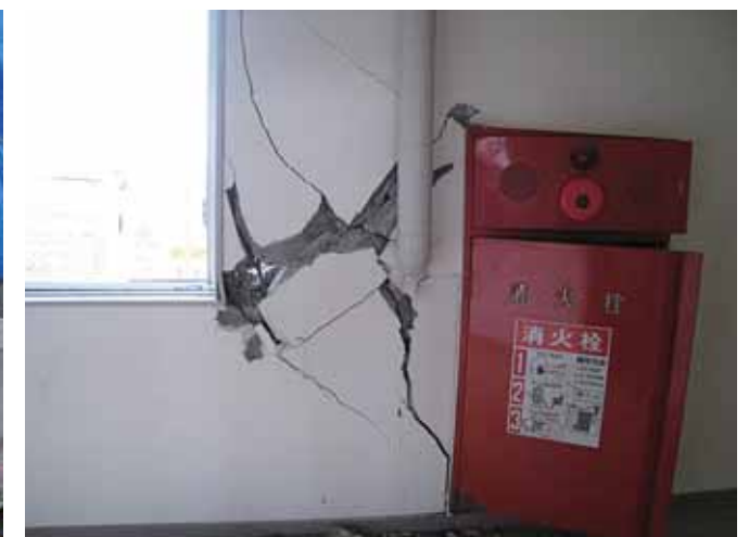
東郷小学校 内壁が激しく損傷
