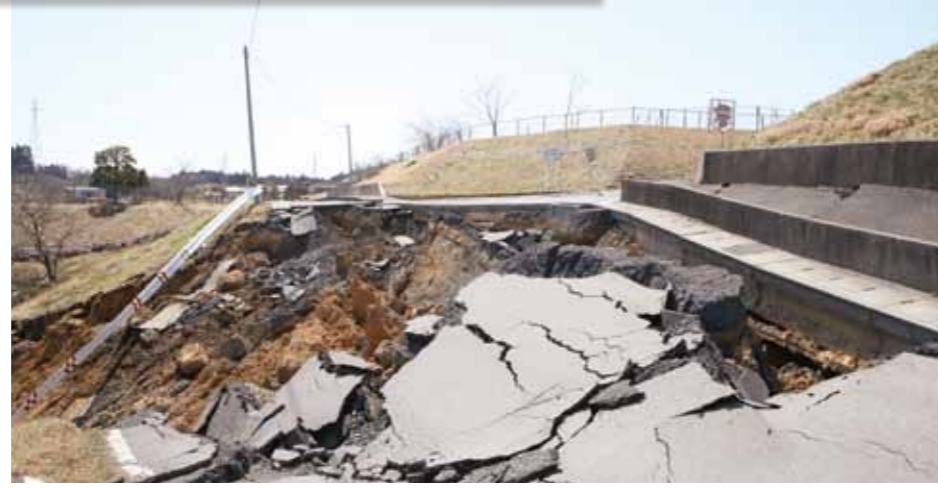
車道が崩れ落ちた→ 東和総合運動公園周辺
