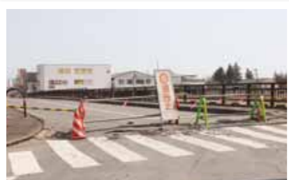
橋脚の破損や落石などにより、通行止め や片側通行になった路線。
