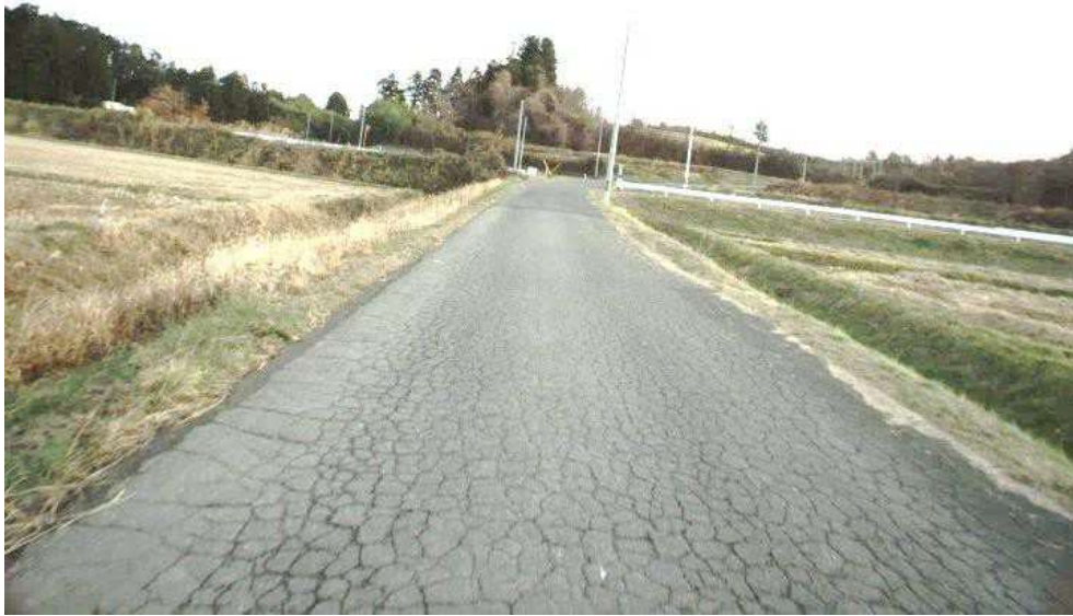
写真 4.1 重度の劣化区間の一例
