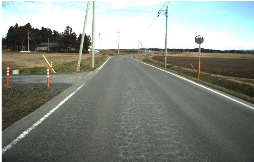
写真 4.2 中度の劣化区間の一例
