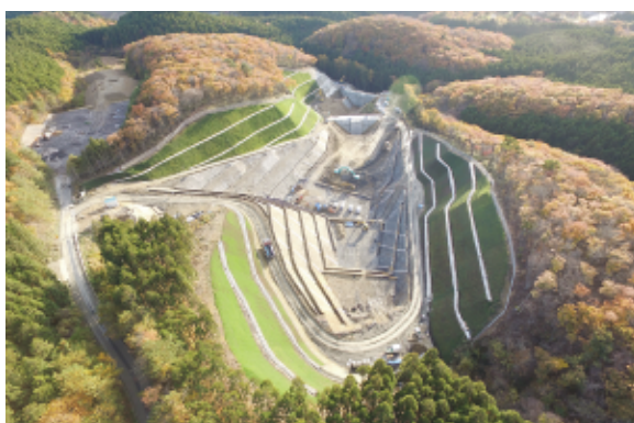
建設工事中の一般廃棄物処理施設第2最終処分場 (平成27年度)
