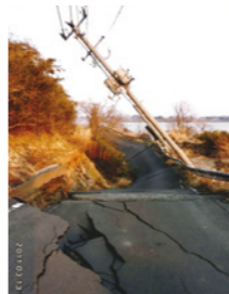
東日本大震災で損壊した道路
