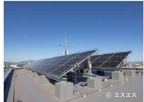
図：太陽光発電設備 (羽島市庁舎)
