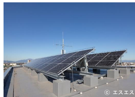
図：太陽光発電設備 (羽島市庁舎)
