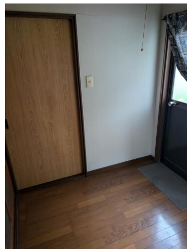
勝手口 脱衣スペース
