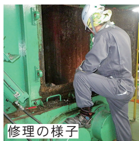
故障した処理施設
