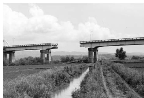
宮城県沖地震により崩落した錦桜橋（中田）
