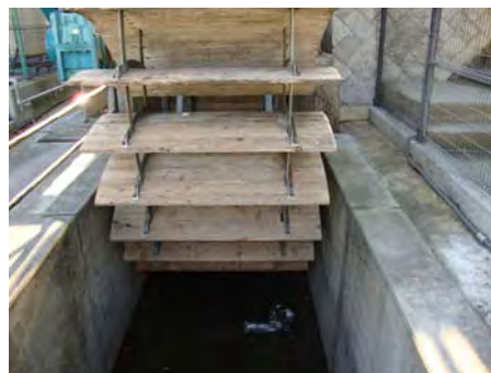
水路とブレード。 ブレードは国産のスギ材36枚が設置してある。
