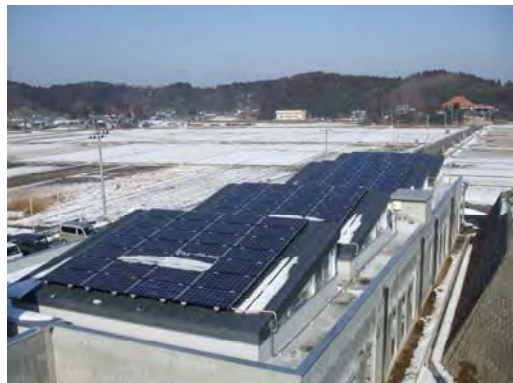
図 2-26 登米市斎場の太陽光発電施設
