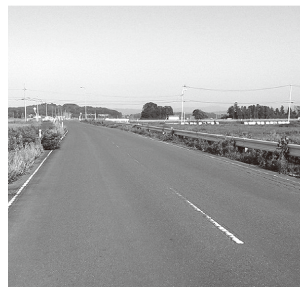
センターラインが消えている道路
