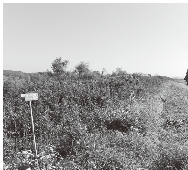
支障木や雑草が繁茂する迫川堤防（迫町三方島地内）
