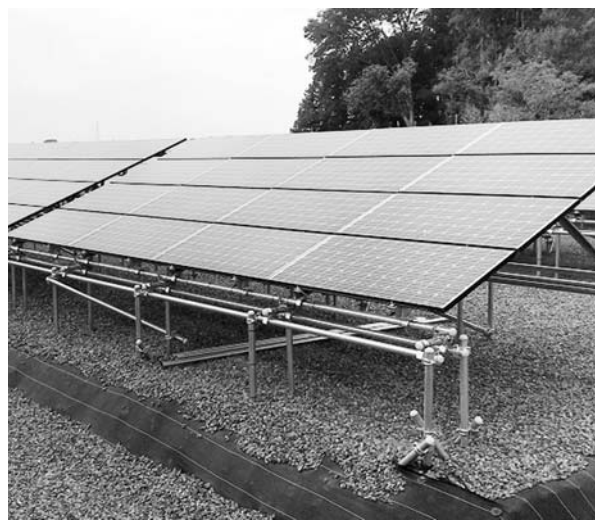
太陽光発電施設
