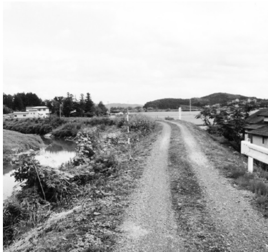
改修が必要な夏川堤防（石越町内）
