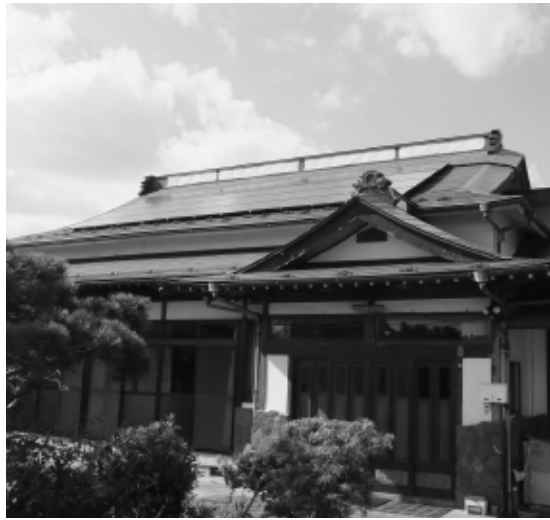
屋根に設置した太陽光発電設備
