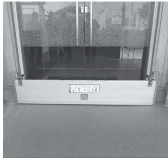
民間事業者が設置した軽量の止水板
