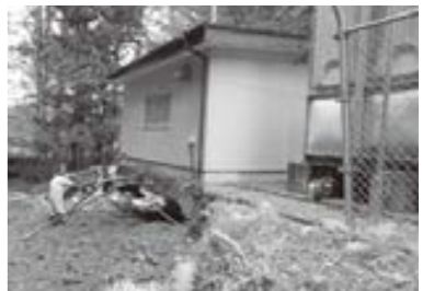
市の簡易水道施設の基礎が流出(東和町米川)
