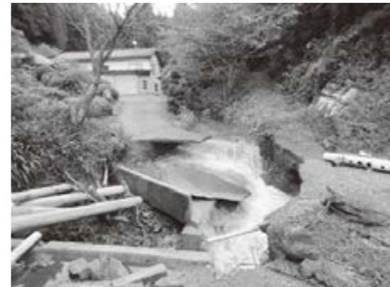
大量の沢水が道路を削る(津山町横山)
