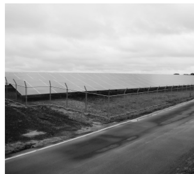
市内事業者が設置した太陽光パネル
