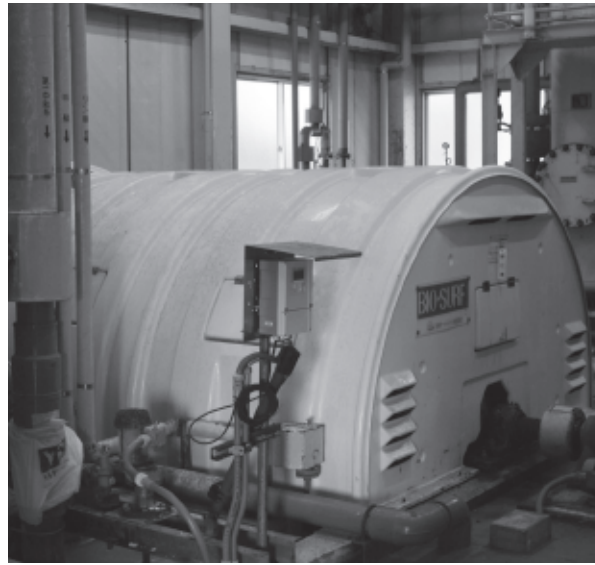
最終処分場 浸出水処理施設
