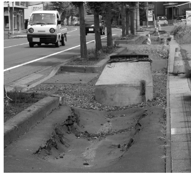
液状化により突出したマンホール
