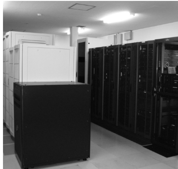
各部局のシステムを統括処理する電算室
