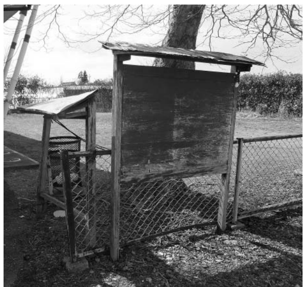
傷みがひどい屋外掲示板
