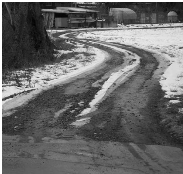
整備が望まれている生活道路
