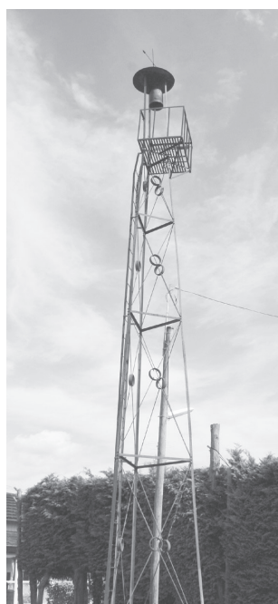
老朽化が進む火の見櫓
