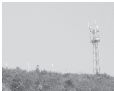
山頂に設置されている共同アンテナ
