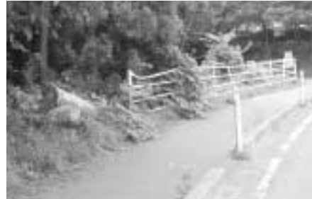
倒木と破損した通学路のガードレール
