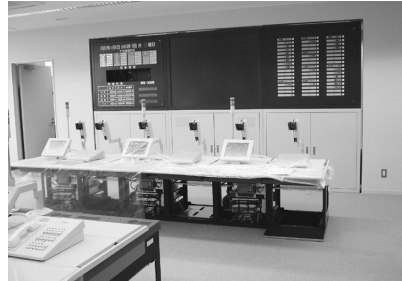
新しくなった消防司令室（消防防災センター）
