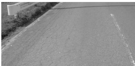
冬期間の低温によりヒビが入った舗装道路
