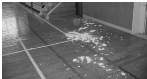
落下しているアスベスト(桜岡小体育館)
