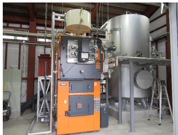
新たに導入した木質バイオマスボイラー
