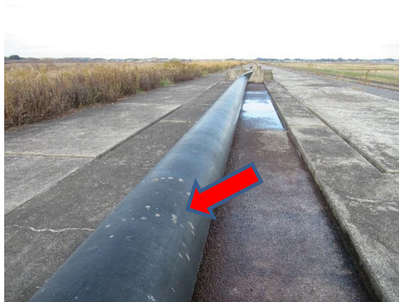
大雨時には、空気を抜いて越流を促す
