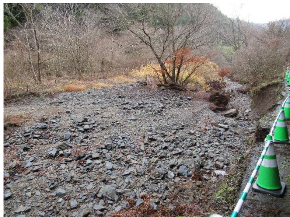
現在も未復旧の被災現場
