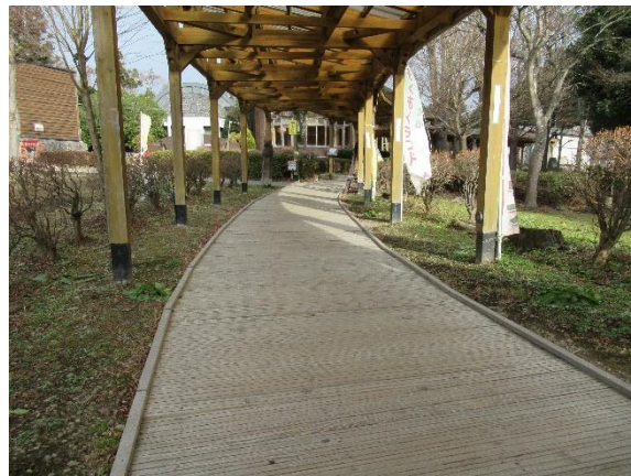
老朽化により、歩行中に段差が生じる木製通路。転倒のリスクがあり、対策が必要である
