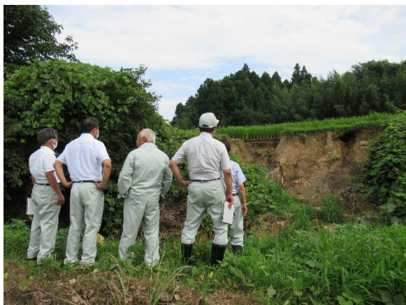
農地の法面が崩壊した現場
