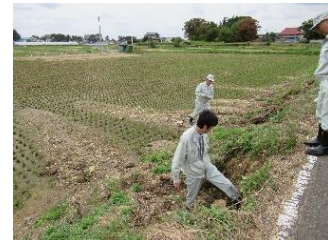
市道法面が農地に流入
