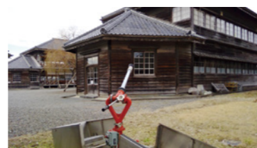
初期消火用放水銃
