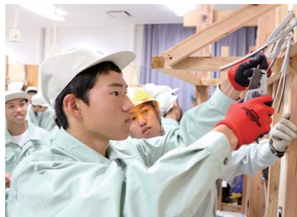
講習会では、配線から照明器具の設置まで実施。住宅の電気工事を想定し、図面を見ながら慎重に配線していました。
