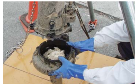
下水道管にモップが詰まっていたこともあります。皆さんご注意ください。
