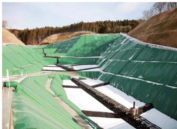
処分場には、埋め立て灰などに浸透した雨水などを無害化する処理施設が併設され、環境の保全に万全を期しています。
