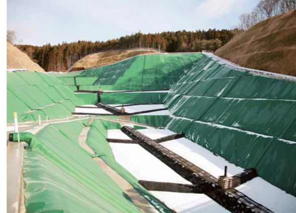
処分場には、埋め立て灰などに浸透した雨水などを無害化する処理施設が併設され、環境の保全に万全を期しています。
