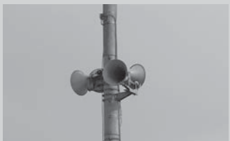
▲震災発生時刻に合わせ、防災行政無線のサイレンを鳴らします
