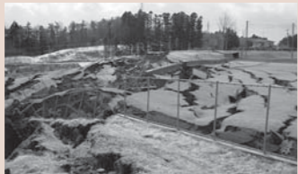
▲地震で崩落した東和総合運動公園
