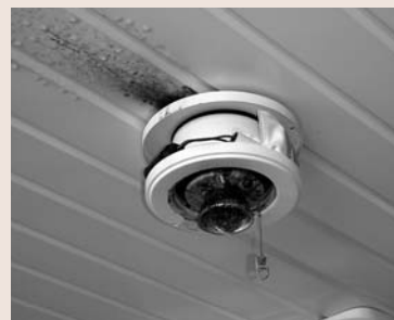
非常照明器具が燃えたもの
