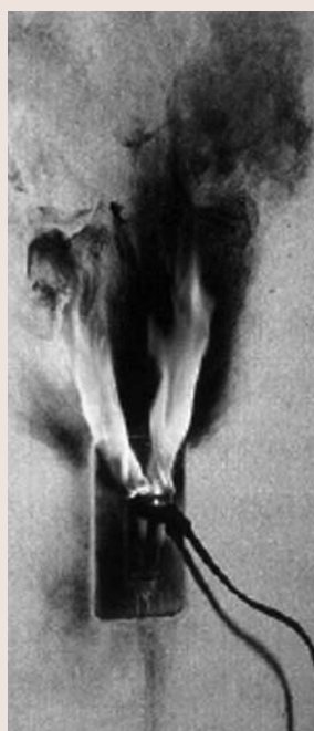
コンセントからの出火（実験）
