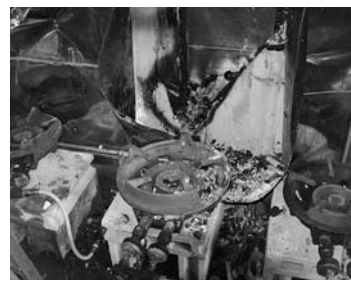
ガスコンロの熱で壁内が燃えたもの
