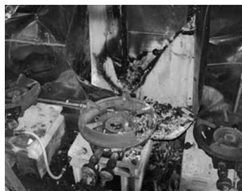
ガスコンロの熱で壁内が燃えたもの
