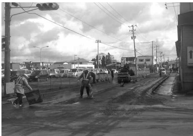
市内各所で順次復旧作業が行われている「道路災害箇所」
