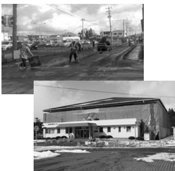
本格復旧が進む市道（上）と復旧工事中の石越体育センター（下）
