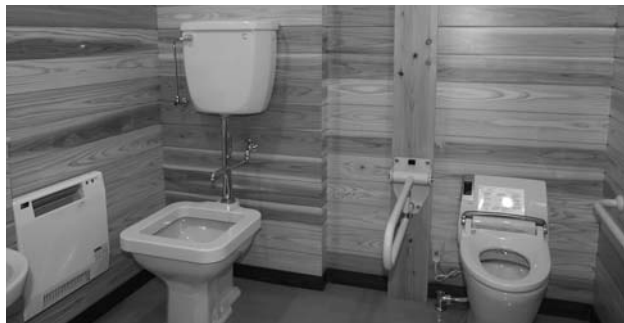
▲1階 多目的トイレ ベビーベッドも設置されています
