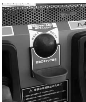
◀中央の黒い部分が静電気除去装置
