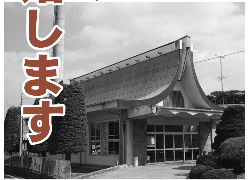
手狭なうえ、老朽化が進んでいる現在の火葬場（昭和47年建築）
