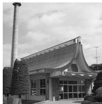
老朽化が進んでいる火葬場
